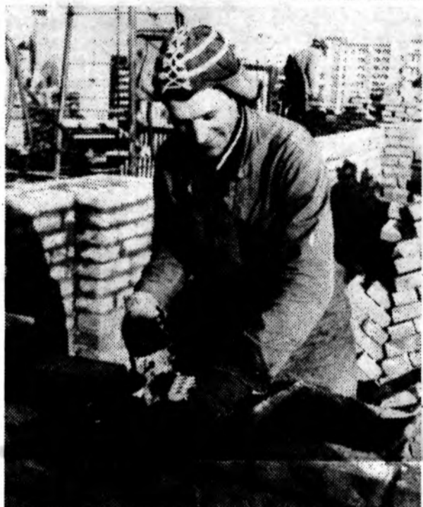
Коммунист Иван Петрович Деревнин — один из лучших каменщиков на строительстве комсомольско-молодежного жилого дома № 285. По итогам работы за первый квартал он занял первое место.
