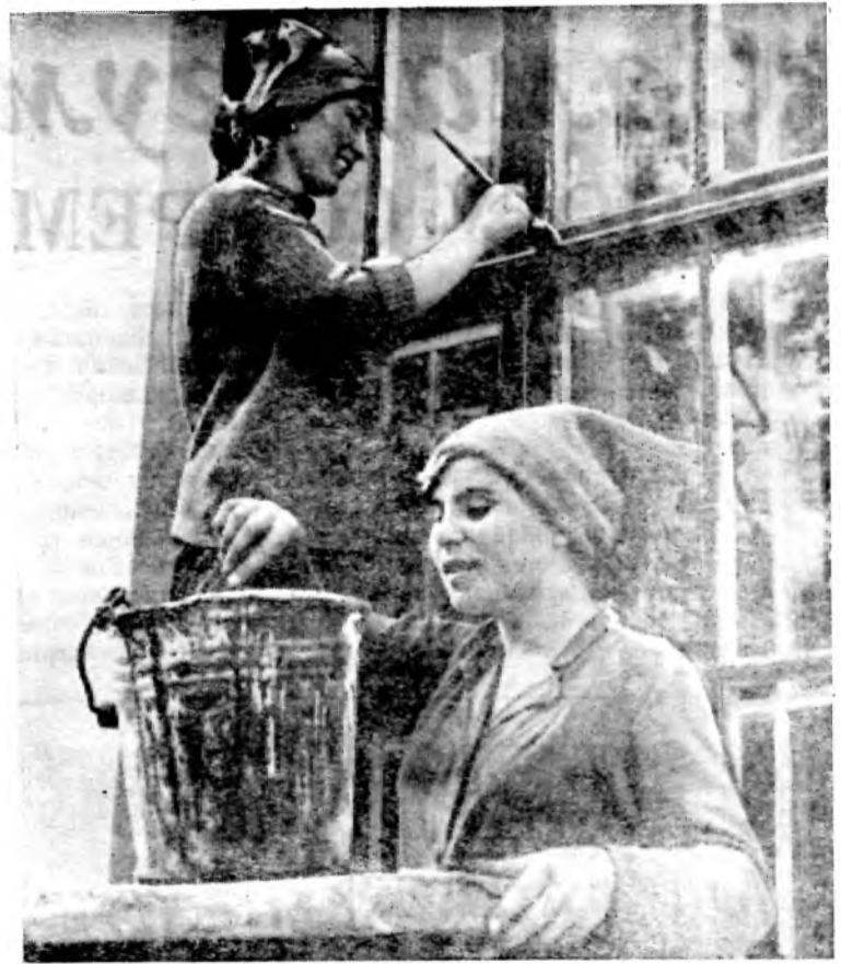
Комсомолки Светлана Колтуненко и Надежда Петренко — выпускницы Ростовского ГПУ. Молодые маляры-отделочники пришли трудиться в Цимлянское РСУ бытового обслуживания два года назад. Девушкам поручили ответственное задание — ремонт школы № 1. И они хорошо справились с делом — ежедневно перевыполняют нормы выработки.
